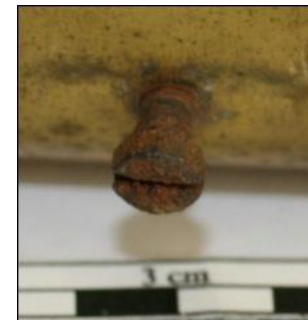
Corrosion galvanique (acier & laiton), © A. Michel
